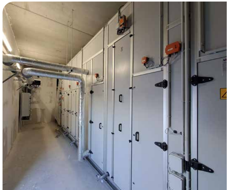
Centrale de Traitement de l'Air de la piscine de Sarralbe
